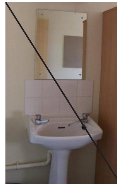
Плохо Раковина с пьедесталом. Фартук из плитки
