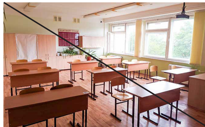
Плохо Линолеум под дерево
